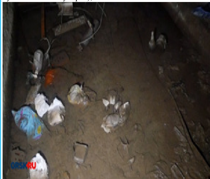
допущено наличие мусора в подвальных помещениях. Важно: согласно пунктам 26, 34 санитарных норм,
